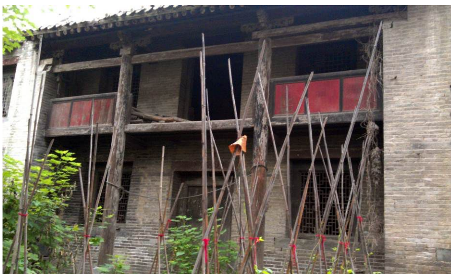
图 2-5 六号民居绣楼烧毁现状
