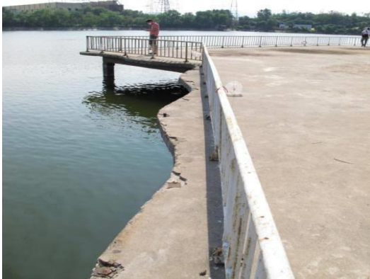
(c) 群明湖北侧池壁现状图
