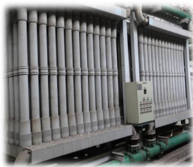
图 4- 91 膜组件的现场实物图
