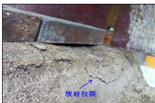
(b)坡肩出现新崩塌区域
