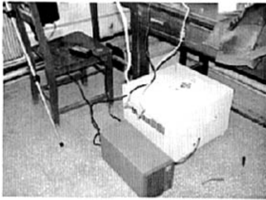
图 2.2c 不间断电源 (UPS)
