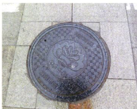
图 5.8 市政井盖 Fig 5.8 The municipal wells
