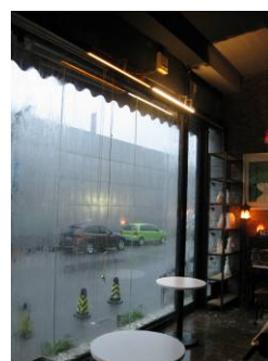
图 2.12 798 艺术区建筑内部新旧结合处雨天漏水情况
