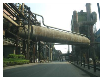
图 4.9 湘潭钢铁厂燃气管道
