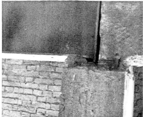
图 4.25 A 列钢吊车梁支座变形
