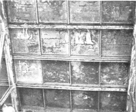
图 4.28 屋面板渗水状况
