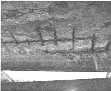
图 4.33 屋面板板面露筋
