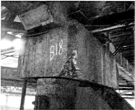
图 4.7 B-18 上柱钢筋外露
