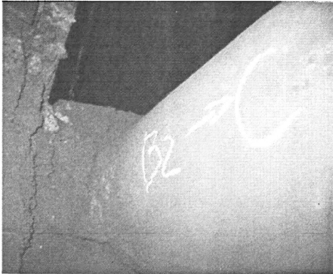
图 4.22 吊车梁与柱连接件断裂
