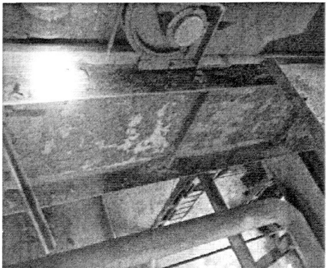
图 4.26 钢吊车梁焊缝夹渣
