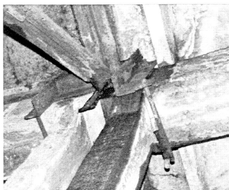
图 4.38 支撑节点锈蚀
