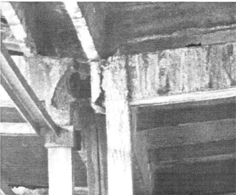
图 4.14 屋架上弦端部局部砼脱落
