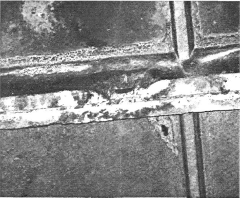
图 4.30 大肋混凝土脱落，钢筋锈蚀
