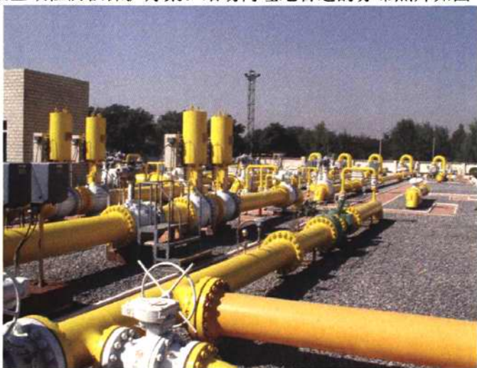
图 3-3 琉璃河站内管道地表分布照片
