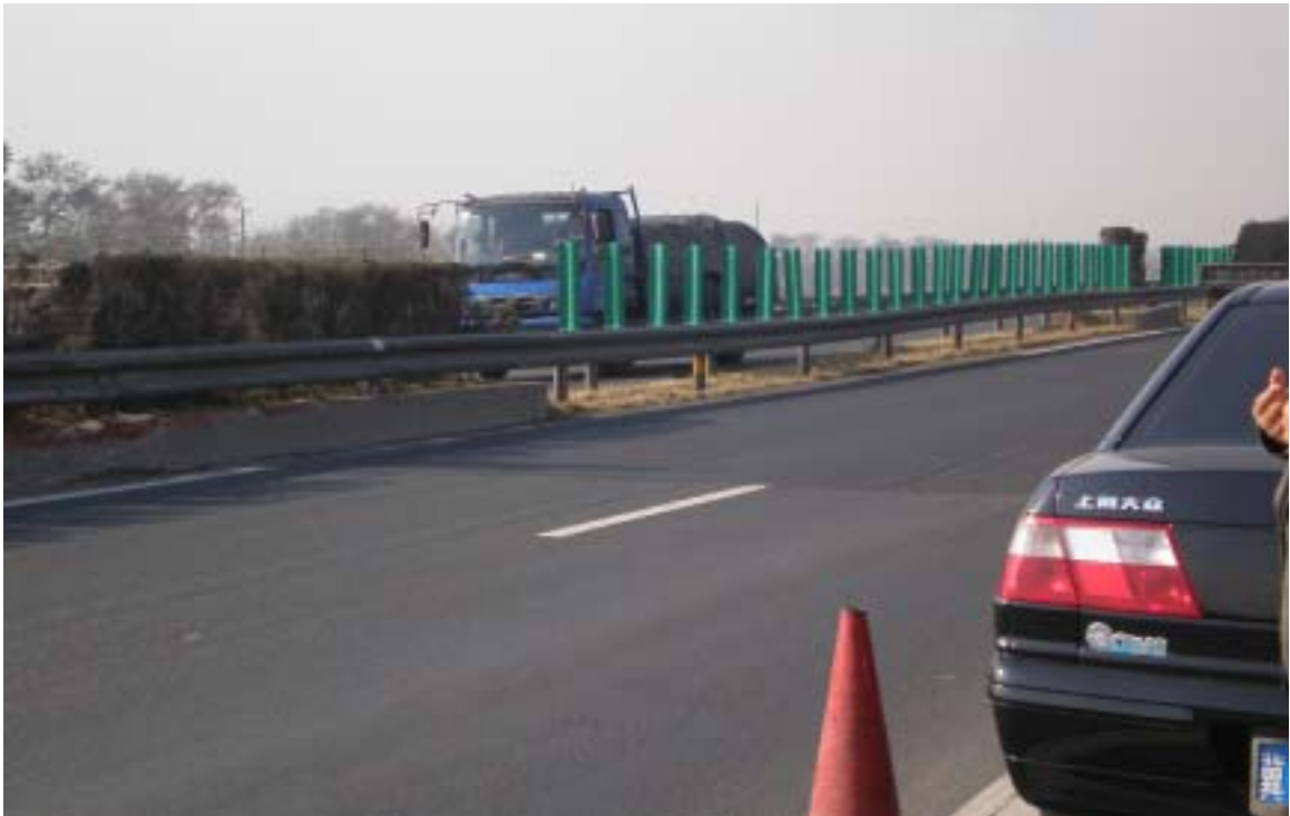
附图11 古运河暗挖段中央隔离带及高速路面沉降情况
