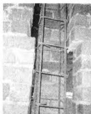
图1 构造柱未设拉结筋
