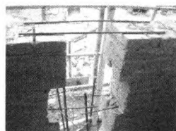
图2 拉结筋长度不足且末端无弯钩
