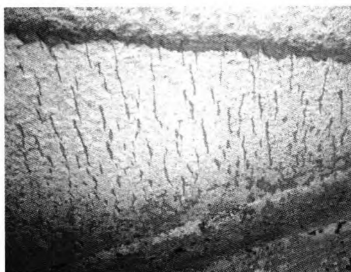
图12 被吹出沟痕的内侧板
