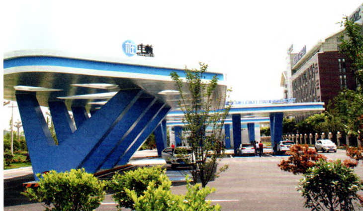
贵州省首座超级充电站
