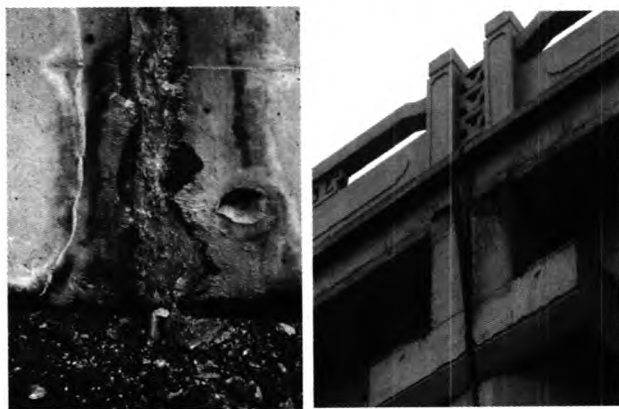
图 3 缝墩碳酸钙渗出物 图 4 伸缩缝止水木板脱落
