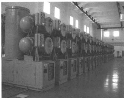
图1 京唐220kV变电站110kVGIS室
