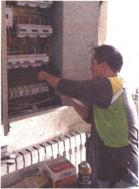
严震在检修配电设备
