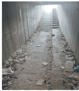
通道内设施老旧,没有照明。
